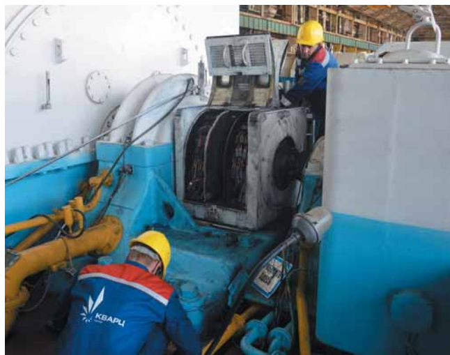
«Инженерный центр энергетики Урала» филиал УралВТИ. В кратчайшие сроки была разработана технология, предусматривающая несколько этапов: пошагово контролируемая выборка сетки трещин
